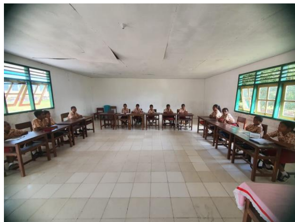
Gambar 2. Atap yang rusak
